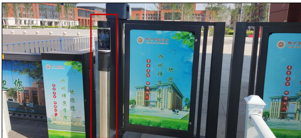
图 5-1 校园一卡通（码）通出入校门刷卡/码/脸设备
